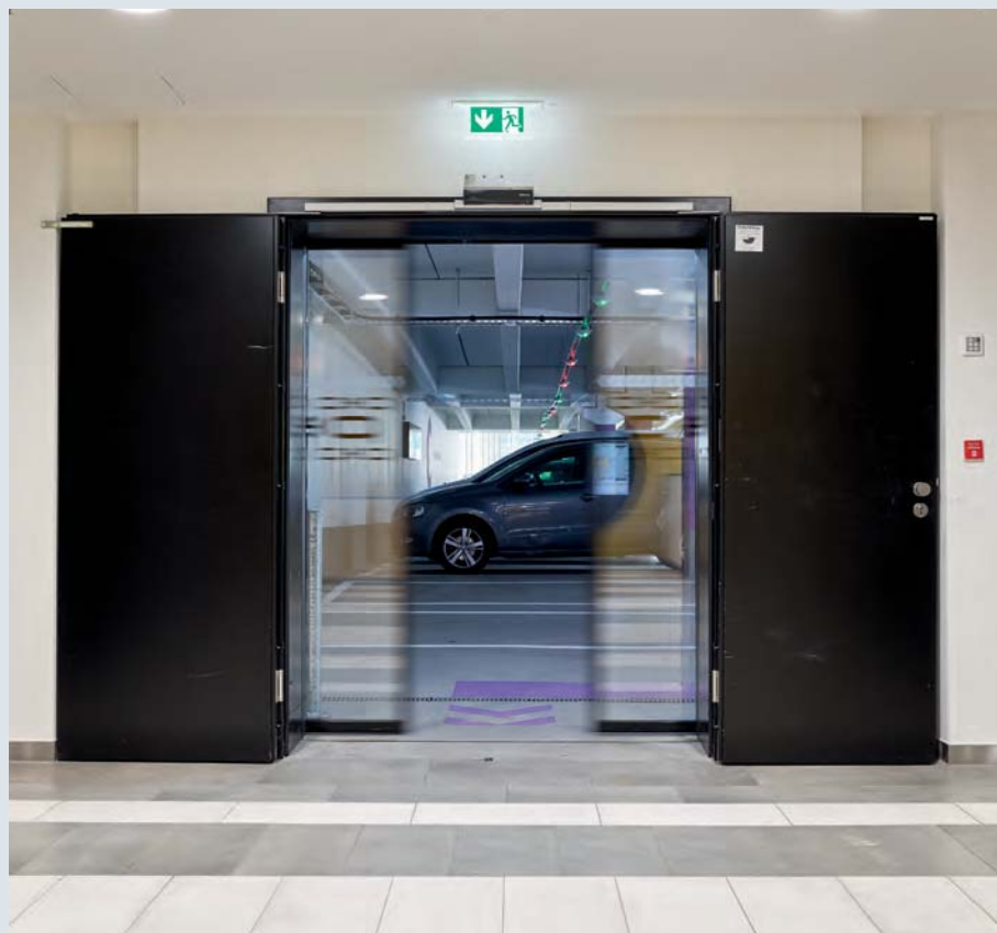
Ansichtsseite Feuer- und Rauchschutztür (Tagbetrieb)
